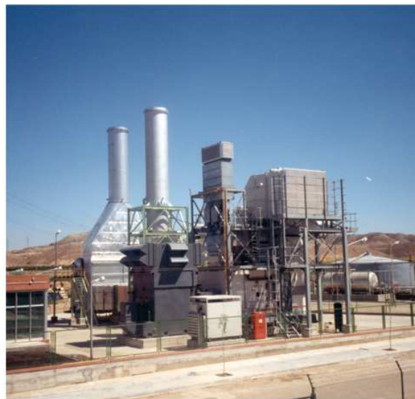
Planta de 15 MW con Refrigeración del aire de Combustión. La Zaida (Aragón).
