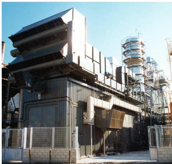
Ciclo Comb. 45 MW y producción de Vapor en El Prat de Llobregat (Barcelona).
