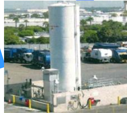
Satellite LNG Station
