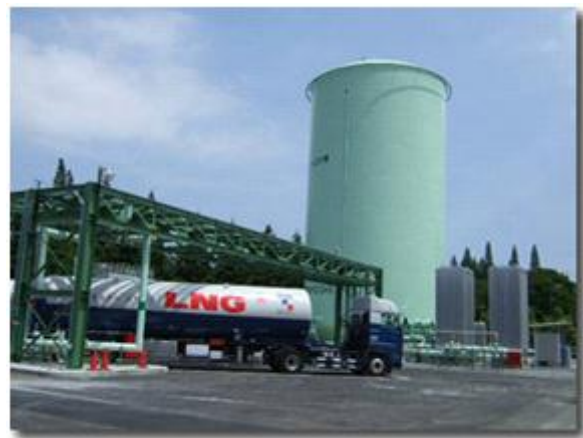
Figure 4.15 LNG satellite terminal
