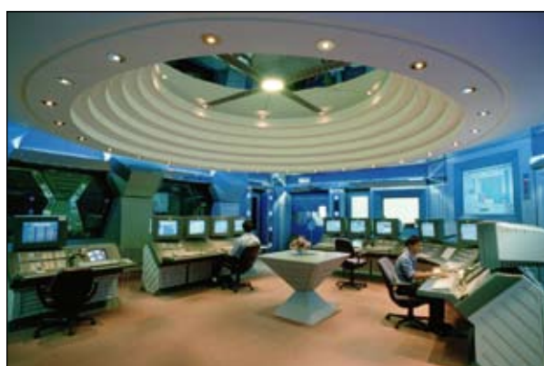
Control room LNG plant
