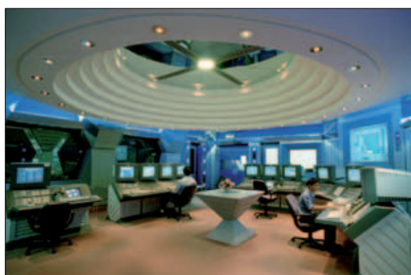
Control room LNG plant
