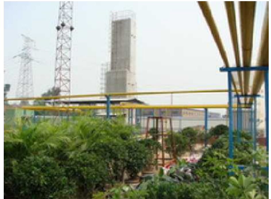
Small LNG plant
